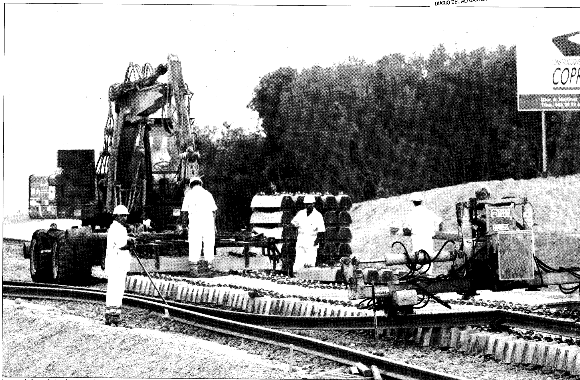
Imagen de los trabajos de ayer en la variante ferroviaria de la capital oscense. VÍCTOR IBÁÑEZ
